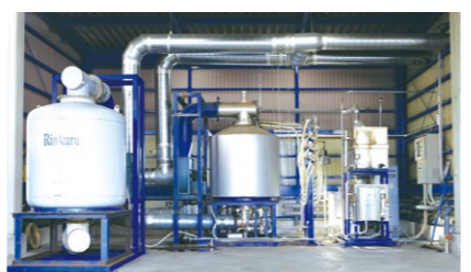
トリクロロエチレンの曝気・気体の吸着を行う設備
